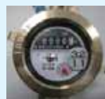
水道メーター写真
