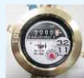
水道メーター写真
