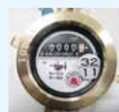
水道メーター写真
