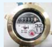
水道メーター写真
