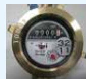
水道メーター写真
