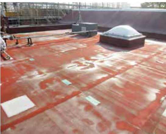
仲原保育所 屋根防水シートの劣化状況
