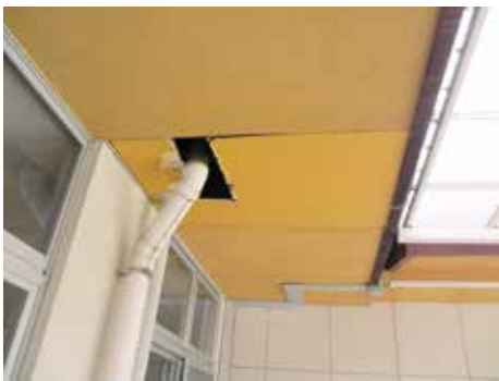
中央保育所 園庭側園児出入口付近の軒部、雨漏りによる破損
