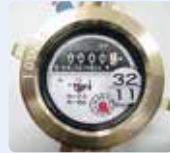
水道メーター写真
