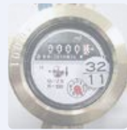
水道メーター
