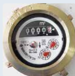
水道メーター
