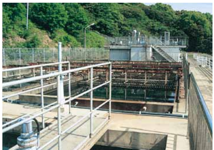
粕屋町浄水場
