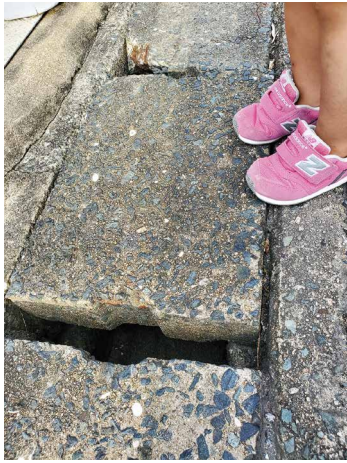
危険な道路側溝ふたの劣化
