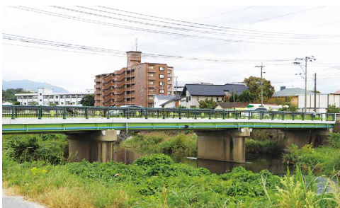
江辻橋橋梁補修工事 7,914万円(令和元年・2年度の2か年) (令和元年度 3,211万円)
